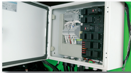
Übersichtlicher Elektroverteiler mit klarer und deutlicher Beschriftung – leichte und schnelle Fehlerdiagnose Clearly organised electrical distribution with distinct labeling - easy and quick trouble shooting
